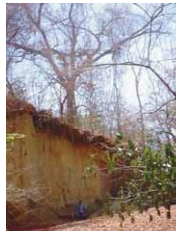
Figura 9. Frente de erosión de 8 m de altura, que muestra la profundidad del caudal de agua del caño El León en una propiedad privada en el estado Portuguesa. Foto: Fudena, A. Rial.
