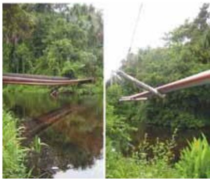
Figura 9. La falta de mantenimiento de tuberías puede provocar su ruptura y ocasionar la contaminación masiva por petróleo de los ríos de morichal.
